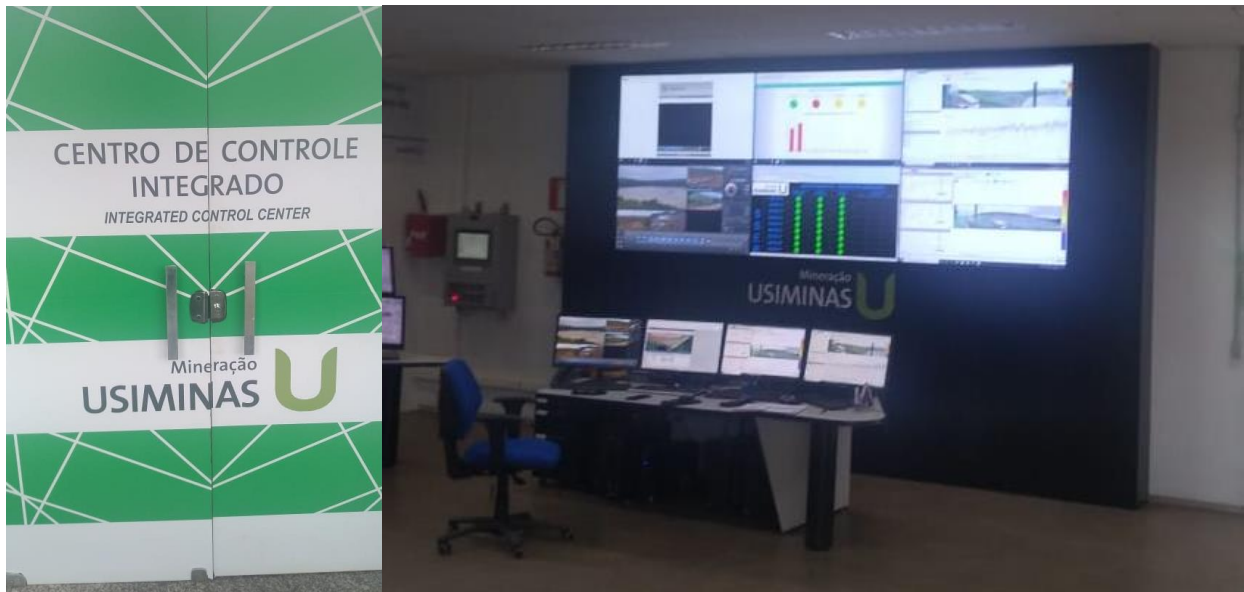
Fotos 1 e 2: Centro de Controle Integrado e posto de Controle e Monitoramento da Geotecnia
