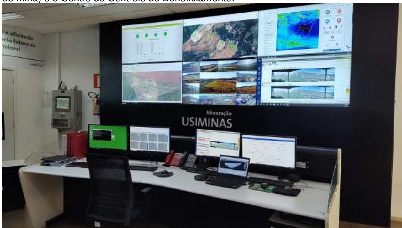
Figura 3-2 – Centro de Monitoramento Geotécnico.
