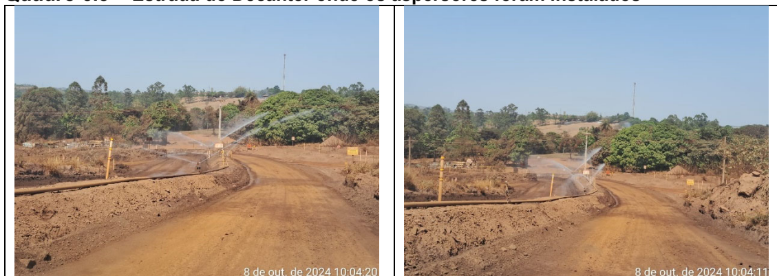
Quadro 6.3 – Estrada do Decanter onde os aspersores foram instalados
