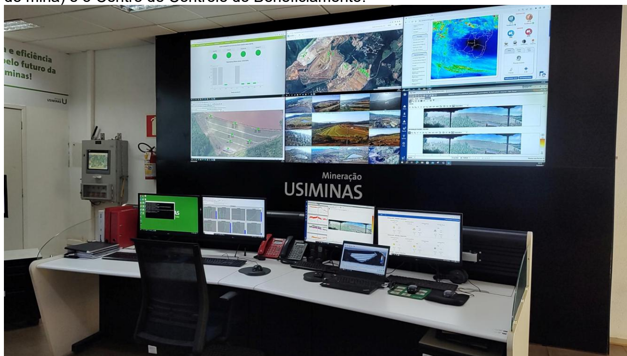
Figura 3-2 – Centro de Monitoramento Geotécnico.
